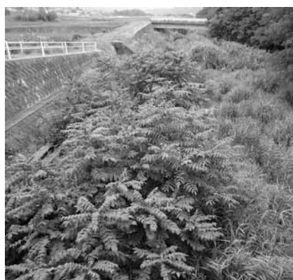
河川内支障木
